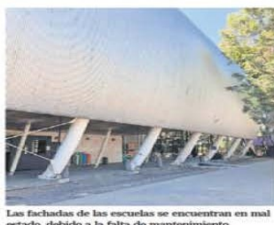
Las fachadas de las escuelas se encuentran en mal estado, debido a la falta de mantenimiento.
