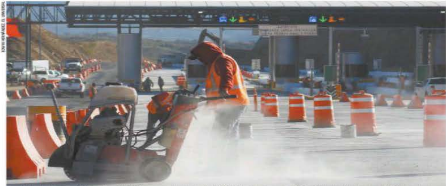
Puerto Escondido.— La autopista que comunica a la ciudad de Oaxaca con Puerto Escondido, inaugurada hace una semana, tiene 27 puntos donde las obras no han sido concluidas. En un recorrido se observó que las casetas no están terminadas y hay decenas de trabajadores y máquinas laborando a lo largo de la vía. | ESTADOS | A12
